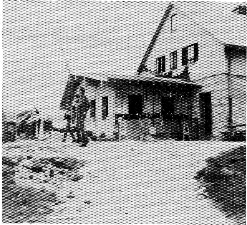
Richtfest auf der Hochries: Der Anbau ist nun bis zum Rohbau gediehen.
